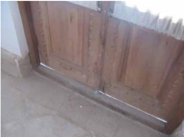
تصویر ۷. شکاف بین در و چارچوب در اتاق دودری خانه علمی یزد و ایجاد تهویه ناخواسته. مأخذ: نگارندگان.
