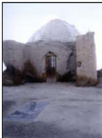
تصویر ۶. بنای چهل دختر، واقع در ضلع غربی امامزاده ابراهیم آناهیتا قاسم خانی. بهار ۱۳۸۱
