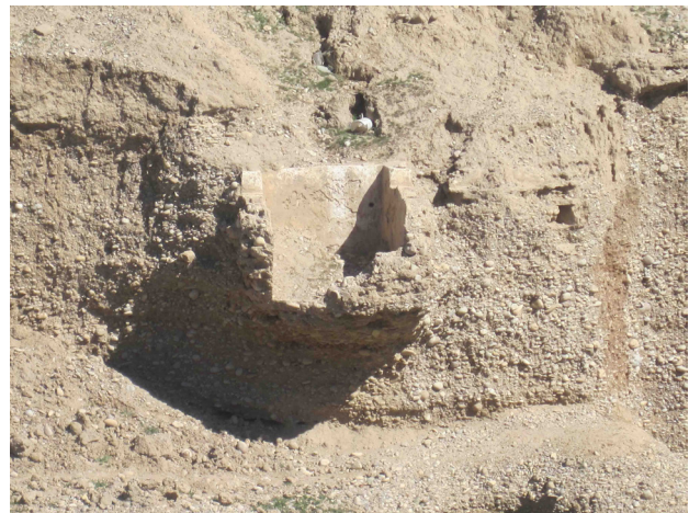
تصویر ۴. قسمتی از سقف فرو ریخته پل‌بند. عکس: حسن اکبری، ۱۳۹۲. Fig. 4. The collapsed roof of Polband. Photo: Akbari, H., 2013.
